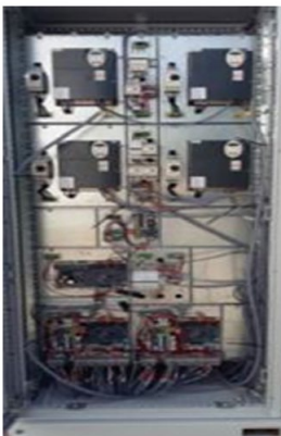
Fläktdrivningar + pumpdrivningar + elektronikkort
